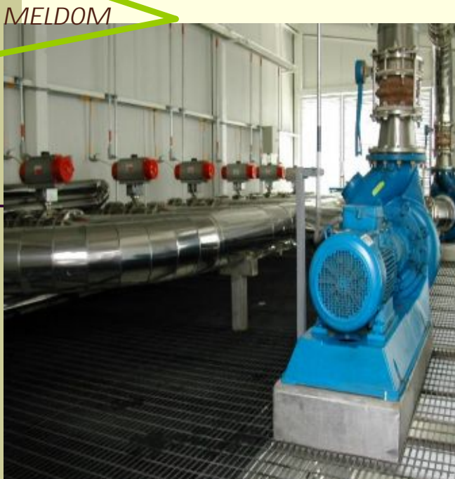
Vue des pompes et des vannes automatisées
