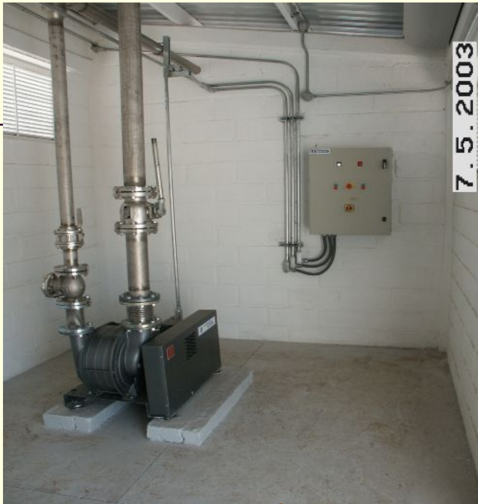
Mise en pression automatisée du biogaz
