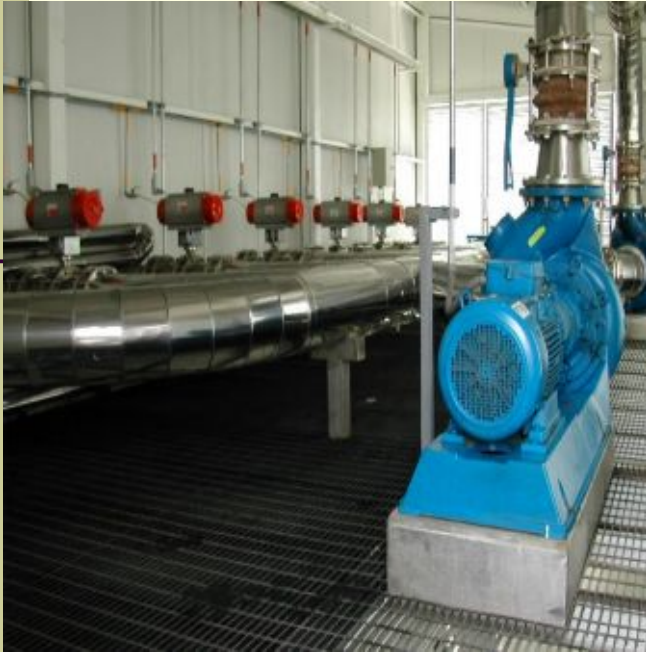
Vue des pompes et des vannes automatisées
