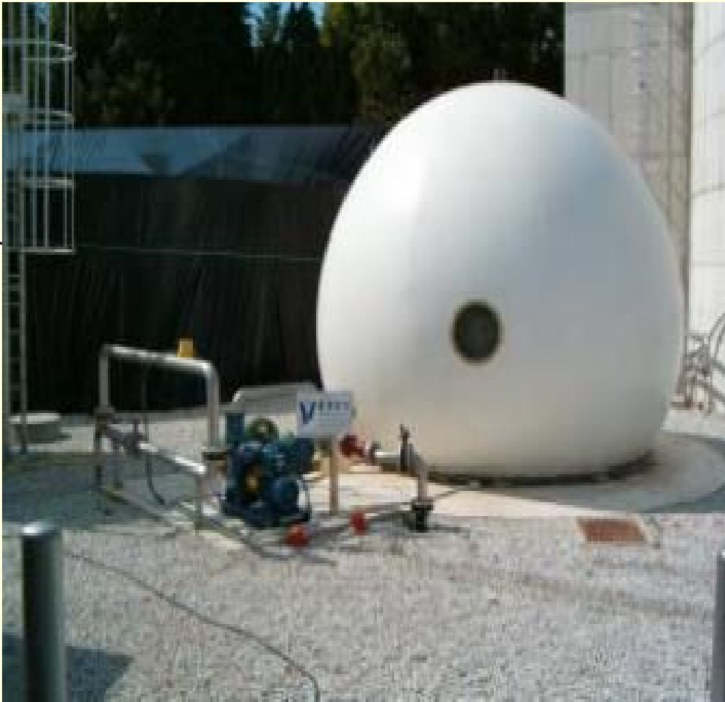
Special biogaz storage « Gazometer »
