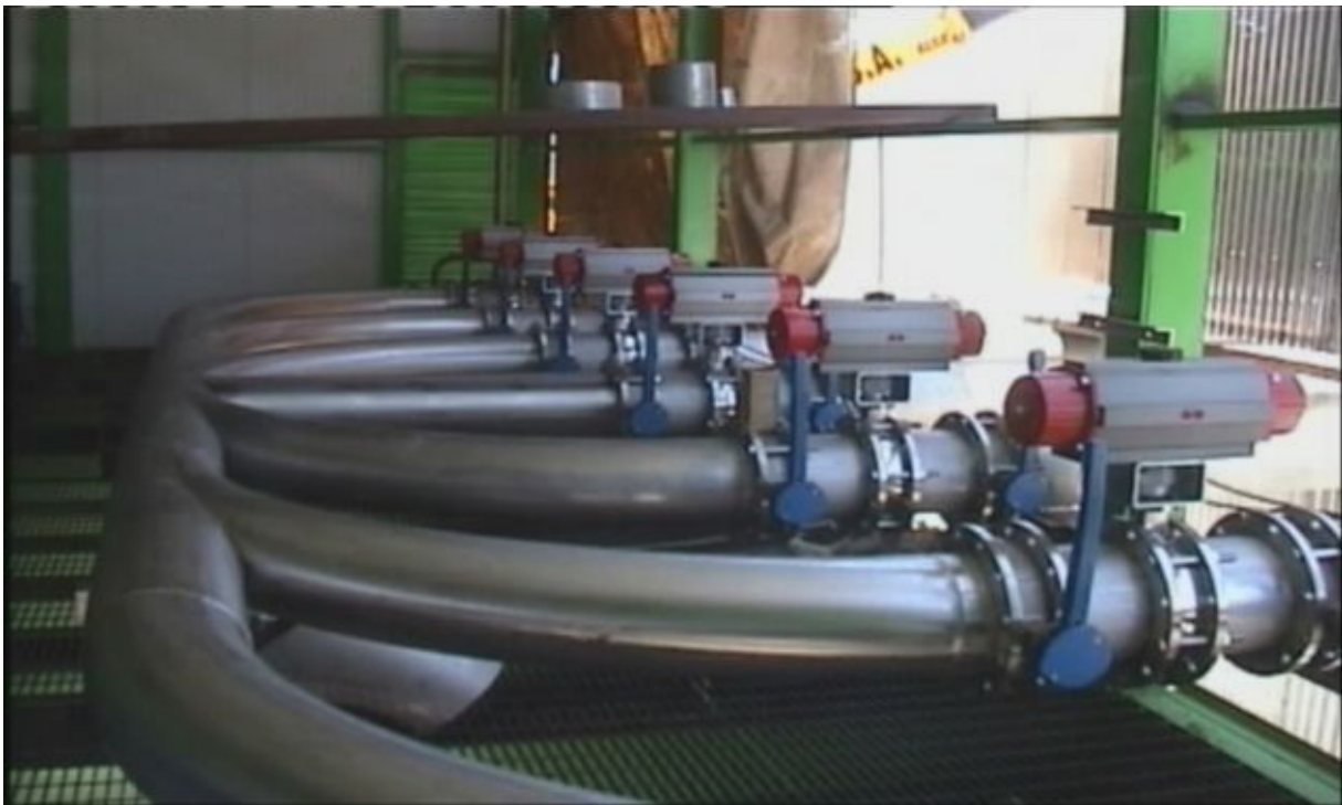
Ensemble de circuits de mélange
