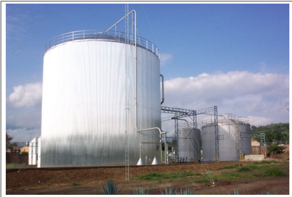
Vue d'ensemble du digesteur de 5000m 3
